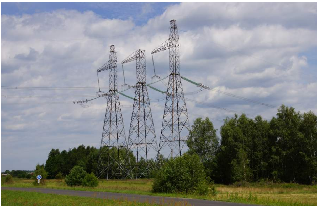
Zespół słupa linii 750 kV
