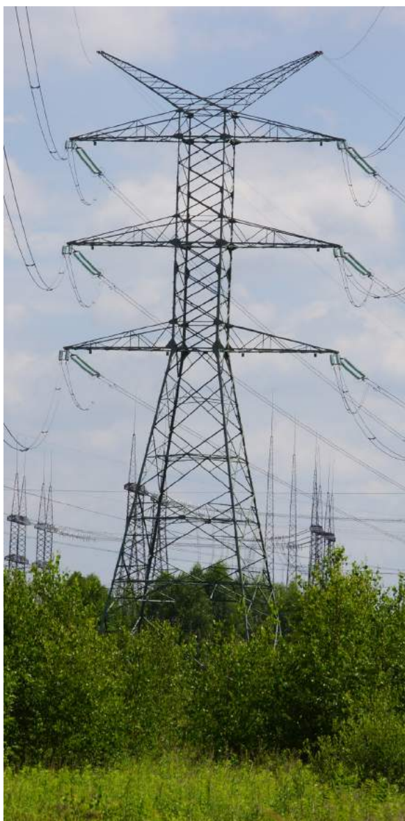
Słup linii dwutorowej NN (400 kV)
