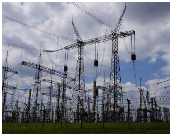
Stacja 750/400/110 kV Rzeszów – fragment rozdzielni 750 kV
