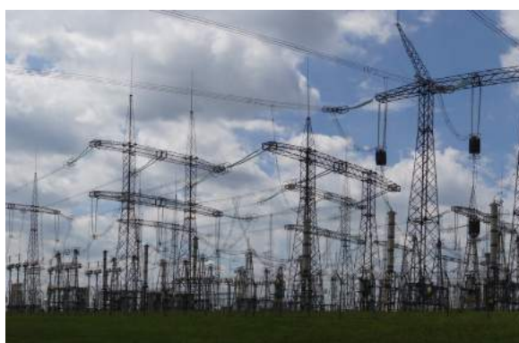
Stacja 750/400/110 kV Rzeszów – rozdzielnia napowietrzna NN
