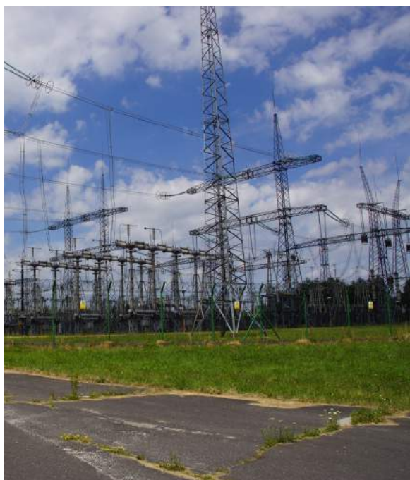
Stacja 750/400/110 kV Rzeszów
